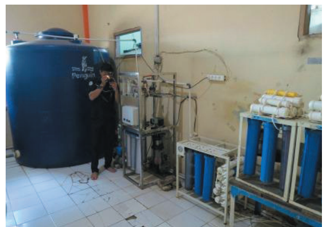
ミネラルウォーターろ過システム
