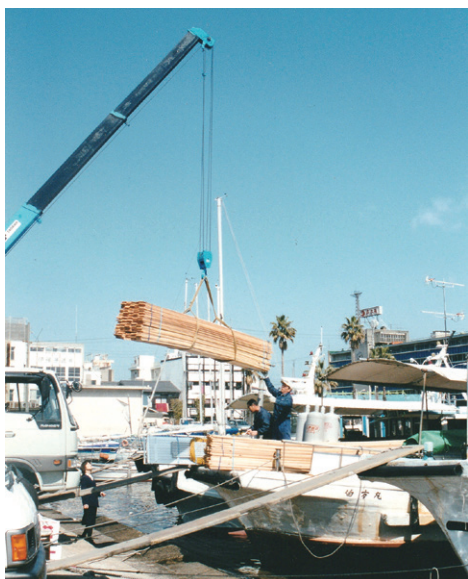
写真9 トウカイサンにクレーンで搭載される建築資材 (撮影：吉村信男)
