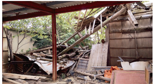
図4 倒壊しかけている空き家
