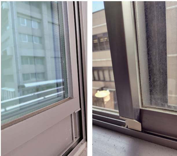
図1（左）愛媛大学内のグリーンホールの窓ガラス （右）研究室の窓ガラス
