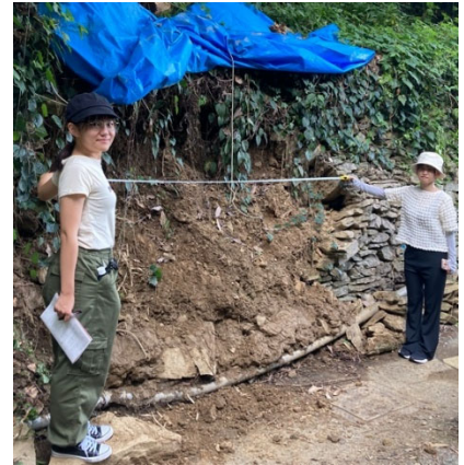
図-11 崩壊した石垣の例 (2023年9月筆者撮影)
